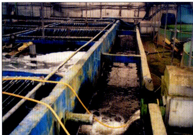
Фото 5. Фрагмент системы очистки воды
